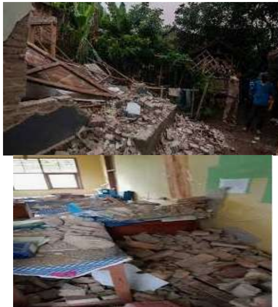
Gambar 4 Contoh Kerusakan Akibat Gempa Pandeglang, 15 Januari 2022
